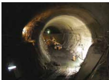
Central Hidroeléctrica El Paso, Decimocuarta Región.
