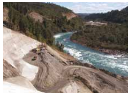
Central Hidroeléctrica El Paso, Decimocuarta Región.
