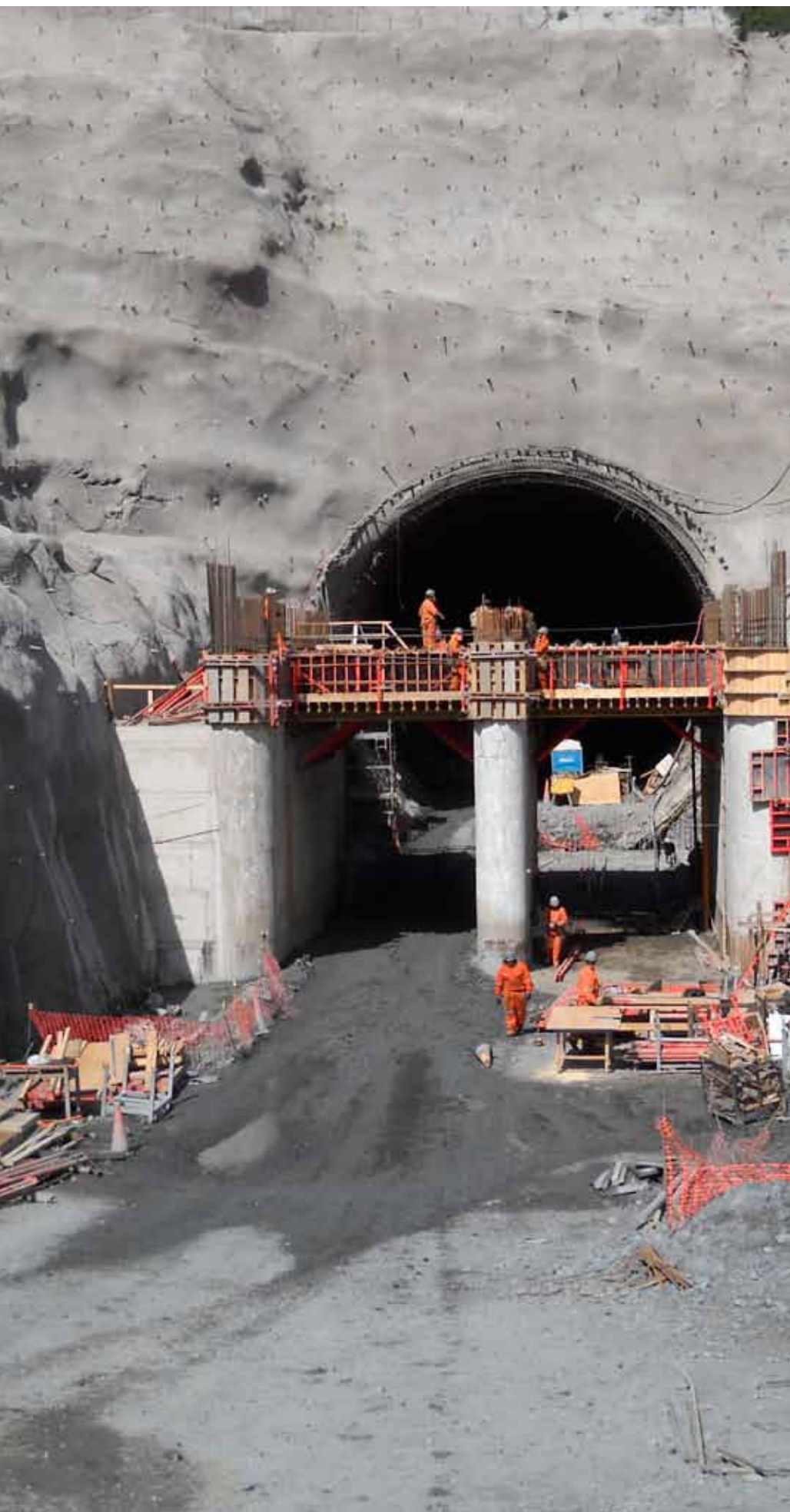
Central Hidroeléctrica El Paso, Decimocuarta Región.
