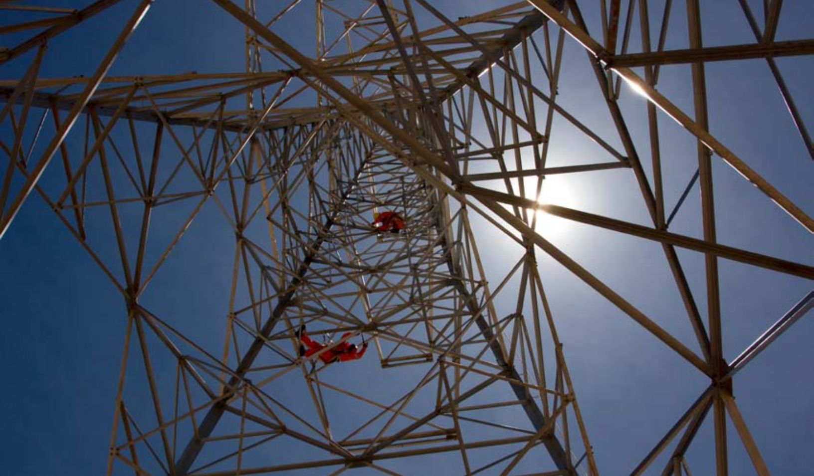
Líneas alta tensión Caserones
